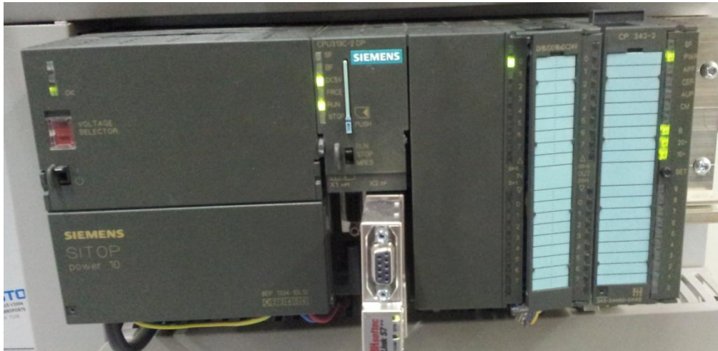
Imatge 11 - PLC Estació transport
