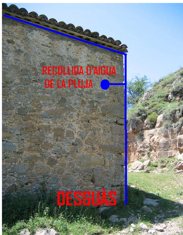
Figura 52- Aprofitament de les aigües pluvials al cobert (juny del 2005)
