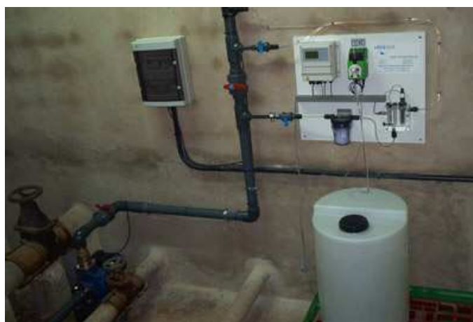
Figura 11- Instal·lació de cloració d'aigua
